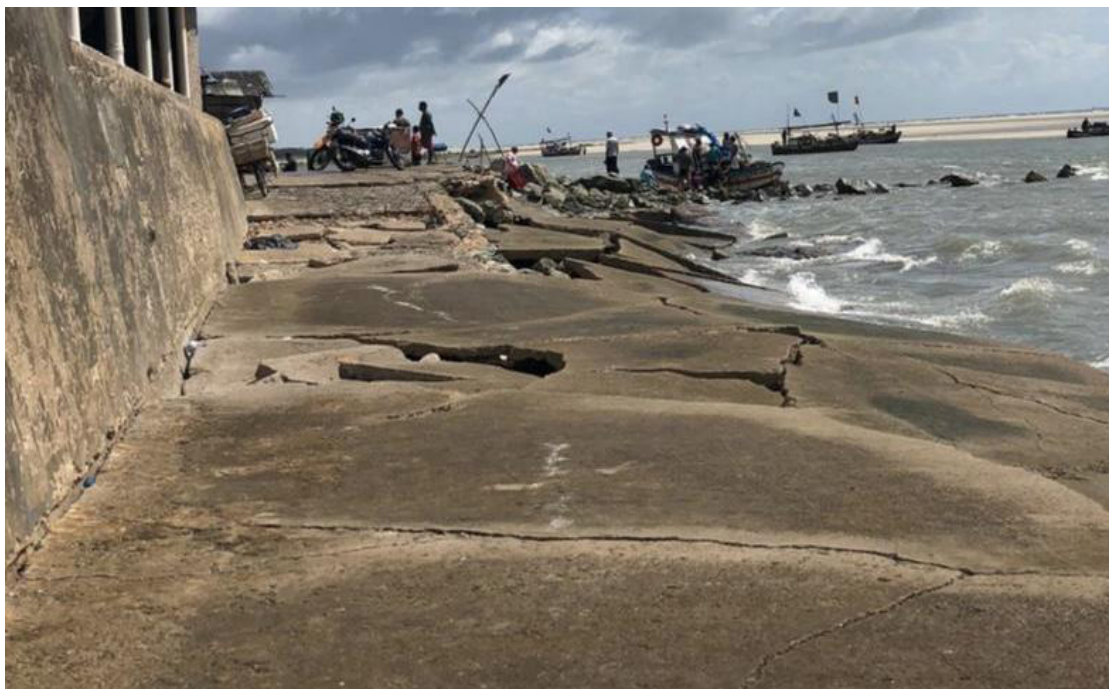
Figura 4 – Caminho para o cais destruído pela maré.
