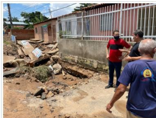
Figura 11 – Reportagem do noticiário Viagora, do dia 05 de fevereiro de 2022, erosão da rua Bela do bairro Satélite em Teresina (Pi).
