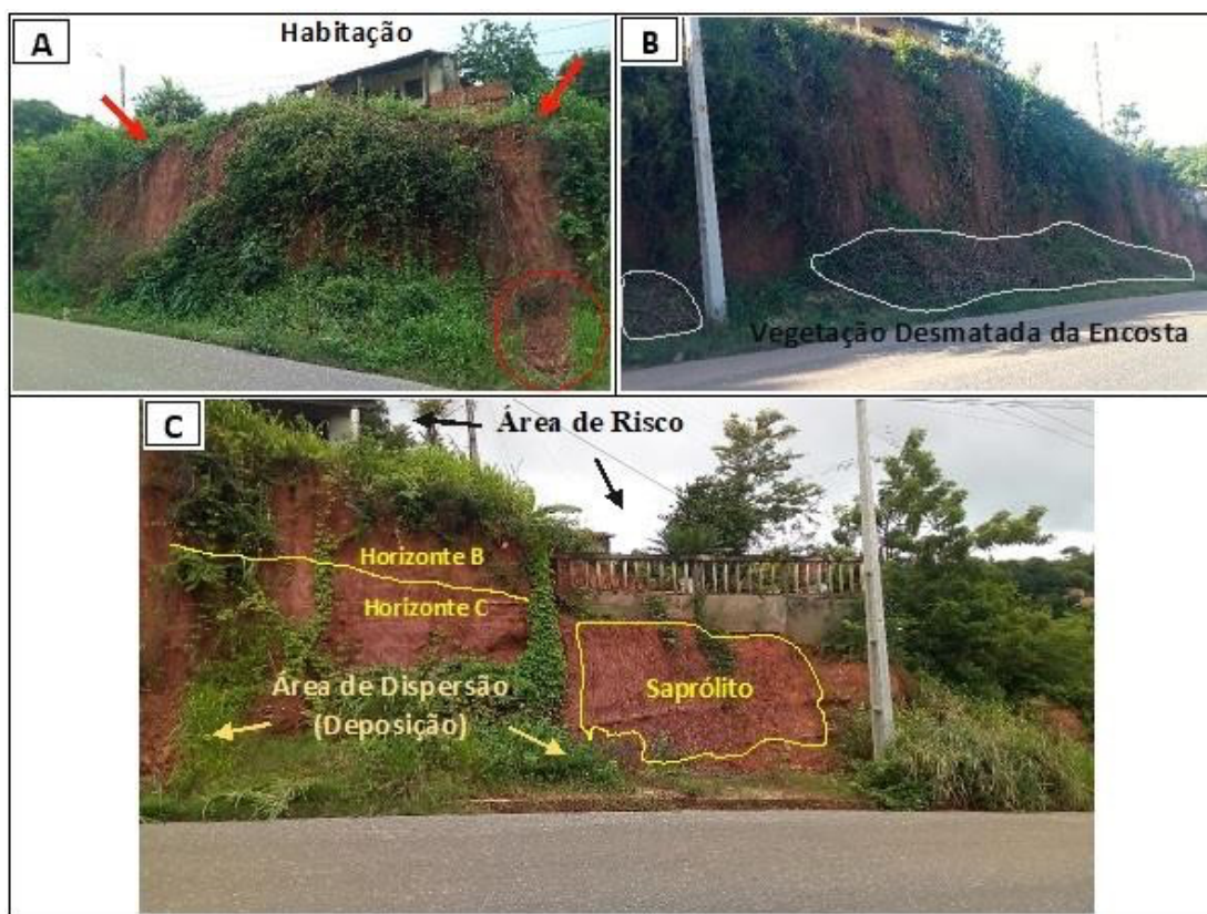
Figura 7 – Movimentos gravitacionais de massa em talude de corte no bairro Verde Lar em Teresina (Pi) nas coordenadas 5°2'19.40" S e 42°44'41.45" W. Em A, movimentos gravitacionais de massa em talude de corte;
