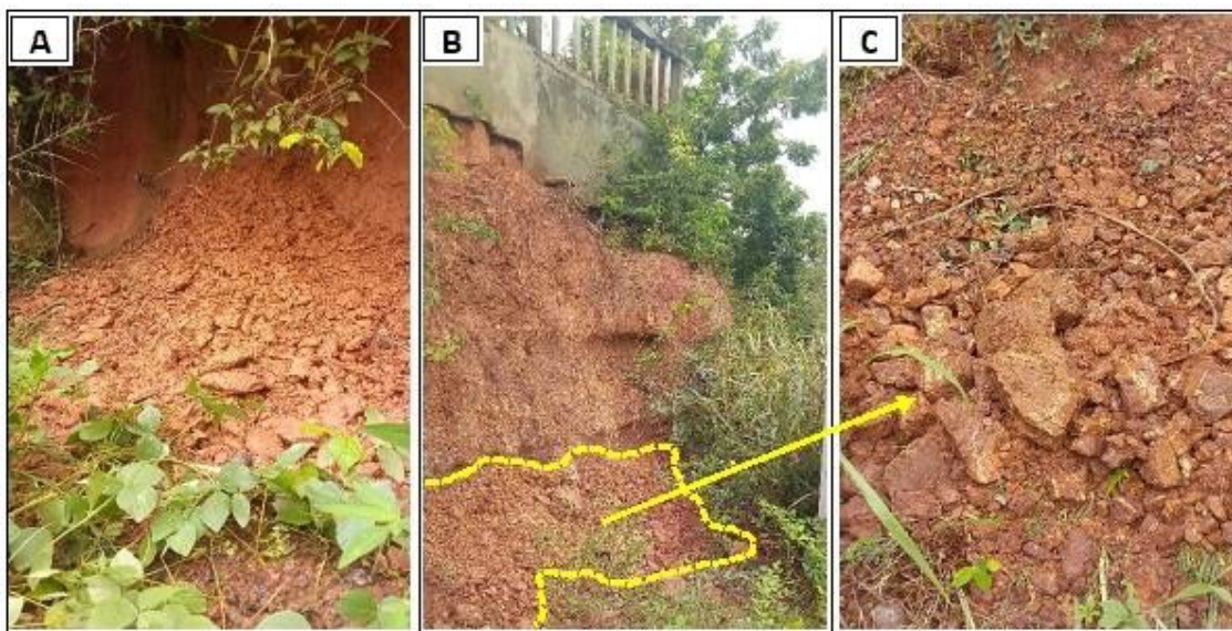
Figura 8 – Material sedimentar na área de dispersão dos movimentos gravitacionais de massa de um talude no bairro Verde Lar em Teresina (Pi) nas coordenadas 5°2'19.40" S e 42°44'41.45" W. Em A, sedimentos da parte mais elevada do talude oriundo do Horizonte B textural. Em B e C, material oriundo de camada saprolítica do talude de corte.
