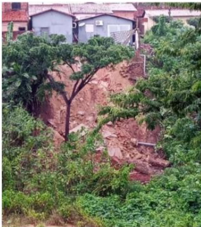
Figura 12 – Reportagem do noticiário da TV Clube, do dia 07 de março de 2022. Famílias deixam casas por risco de desabamento no bairro Vila da Paz (zona Sul de Teresina). Fonte: TV Clube (2022), organizado pelos Autores (2022).
